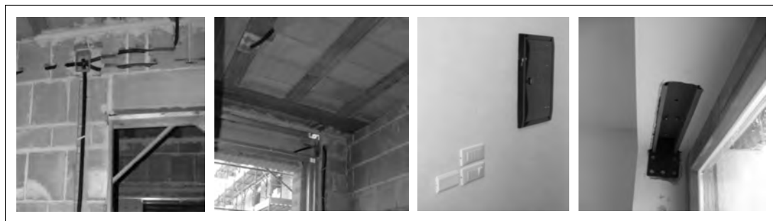
Fig. 10 Esempi di opere di predisposizione impiantistica: tubazioni e scatole di derivazione vuote, tubazioni vuote che raggiungono gli infissi, scatole a muro in sovrannumero, vani per ospitare motorizzazioni di ante.
